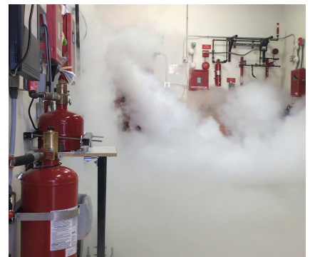
CO2 Suppression System
